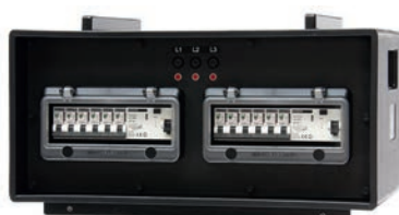
Fusibles apilables en la parte
