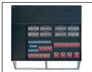
Распределительное устройство настенного типа 800А, источник тока на верфи.
