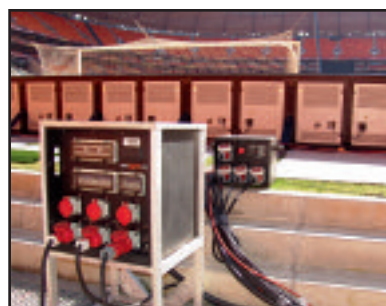
Главное распределительное устройство 250А и промежуточное распределительное устройство 125А для ЧМ 2010.
